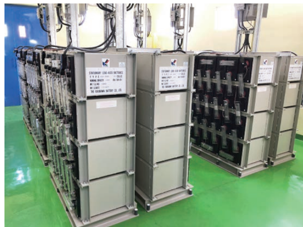
図 2 蓄電池室内部
