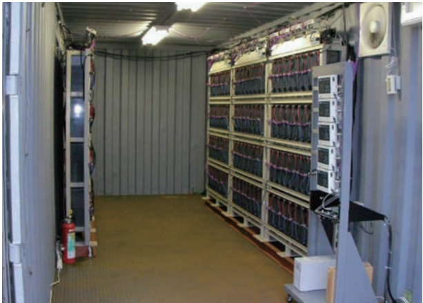
図 3 蓄電池群 Fig.3 String of Batteries
