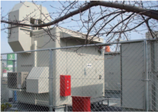
図8 25kWh 蓄電システムを内包したキュービクル「いのちのたび博物館」にて Fig.8 Cubicle with a built-in 25kWh-ESS at “KITAKYUSHU MUSEUM OF NATURAL HISTORY & HUMAN HISTORY”
