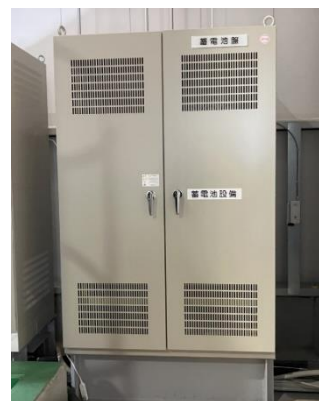
蓄電池盤外観
