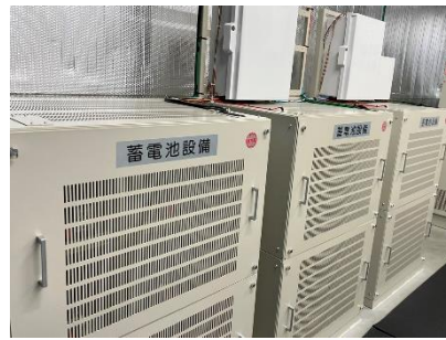
ESS 内部の蓄電池
