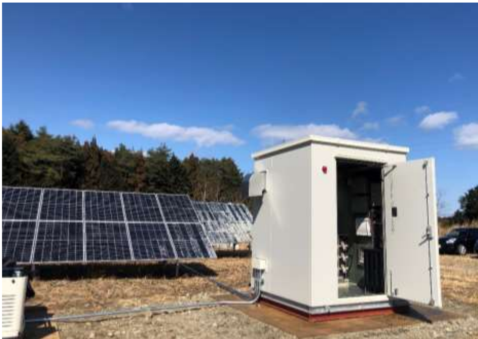
福島県双葉郡富岡町で運用がスタートした「サステナブル・エネルギーソリューション」
