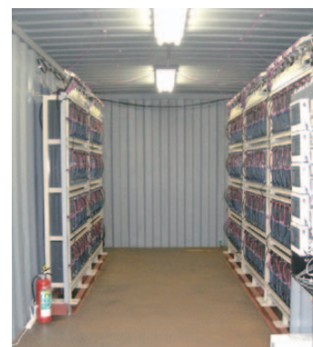
FC50-12 × 160個を用い実証実験を完了。風車の出力変動の平滑化を達成している。
