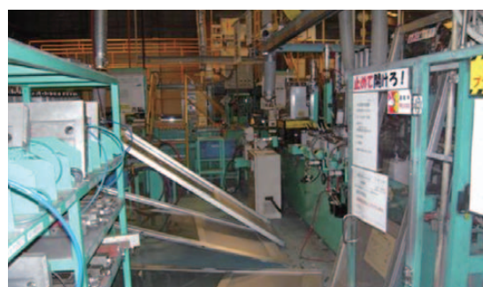
設備損壊の被害
