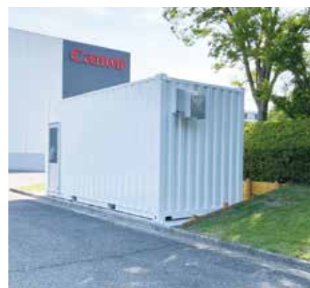
キャノン電子株式会社様 ESS (Energy Storage System)
