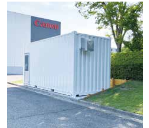
キヤノン電子株式会社様 ESS(Energy Storage System)
